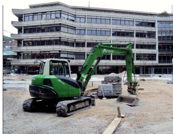
Hier baggern nicht die Studenten: Die Arbeiten auf dem Uni-Campus sind in der finalen Phase.
