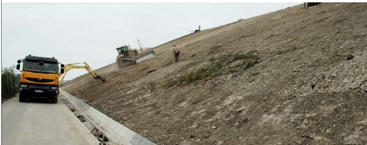
Auf der Sonnenseite: Mit schwerem Gerät – und hoffentlich gutem Gleichgewichtssinn – bereiten die Bauarbeiter in diesen Tagen den Südhang für die Tragekonstruktion der Solaranlage her, die stolze fünf Millionen Euro kosten wird.
